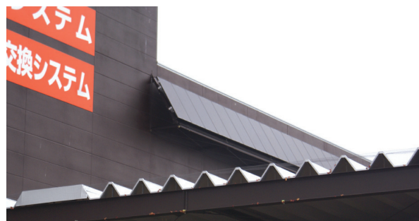
ソーラーパネルは屋根前面に 20 kw 分、122 枚設置
