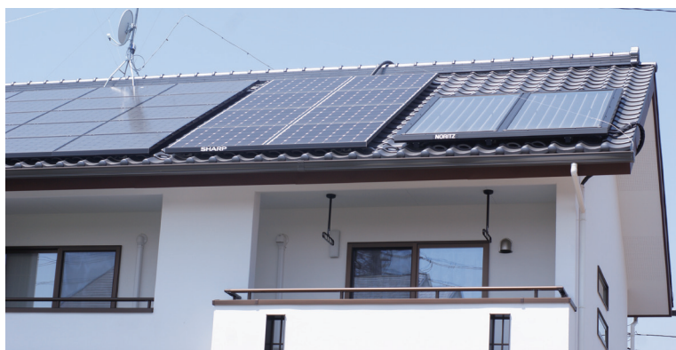
太陽光発電（左、中央）、太陽熱温水器（右）
